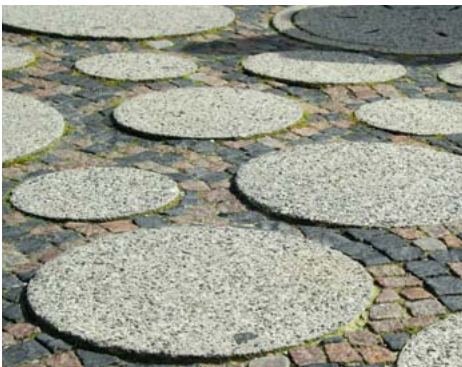
Man sieht es: Durch Unebenheiten entstehen gefährliche Stolperstellen
